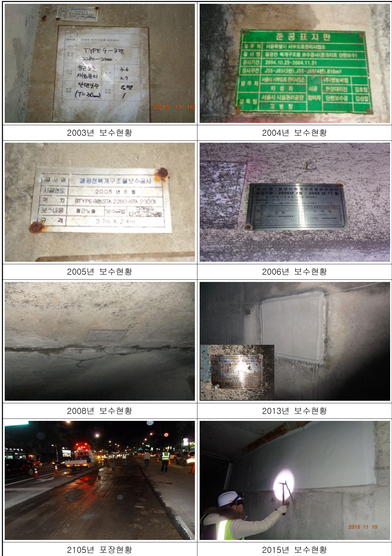
【그림 2.17】 불광천복개1구간 기보수·보강 현황
